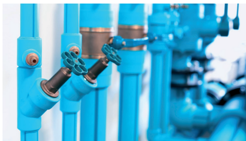
Оборудование для водоснабжения
